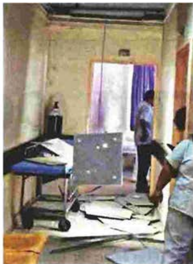
Το μέρος της ψευδοροφής που έπεσε έξω από τα δωμάτια των ασθενών. Από θάυμα δεν τραυματίστηκε κανείς
